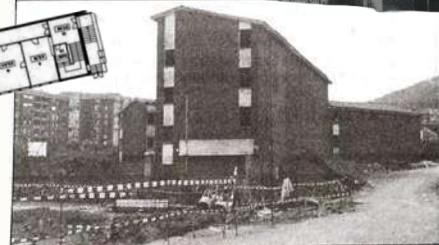
El Ayuntamiento de Castro culpa al Ministerio de Educación del deterioro del antiguo Instituto Ataulfo Argenta.
